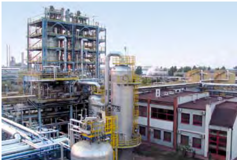
Рис. 1.2. Установка непрерывного окисления – реакторы Biturox® (фот. «ОРЛЕН Асфальт»)
