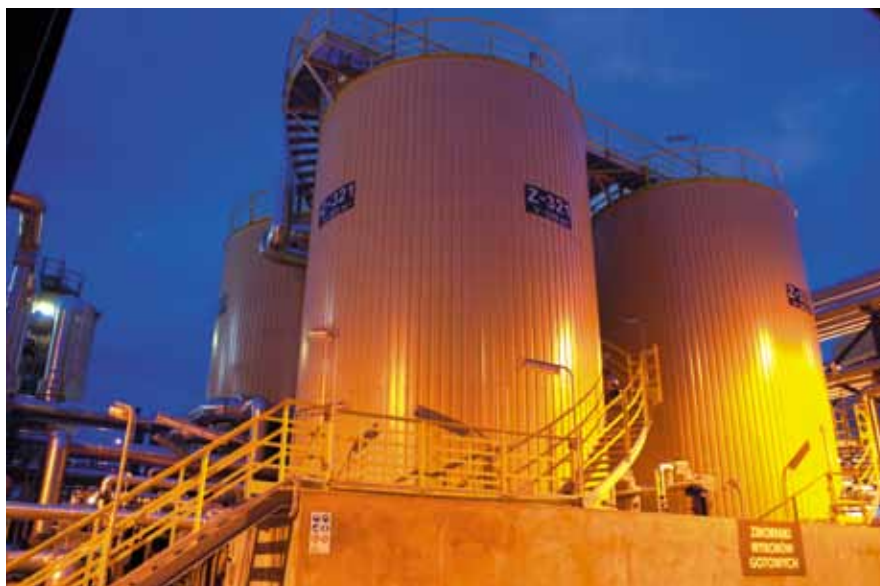
Рис. 9.3. Резервуары для модифицированного битума, установка в Плоцке (фот. ООО «ОРЛЕН Асфальт»)
