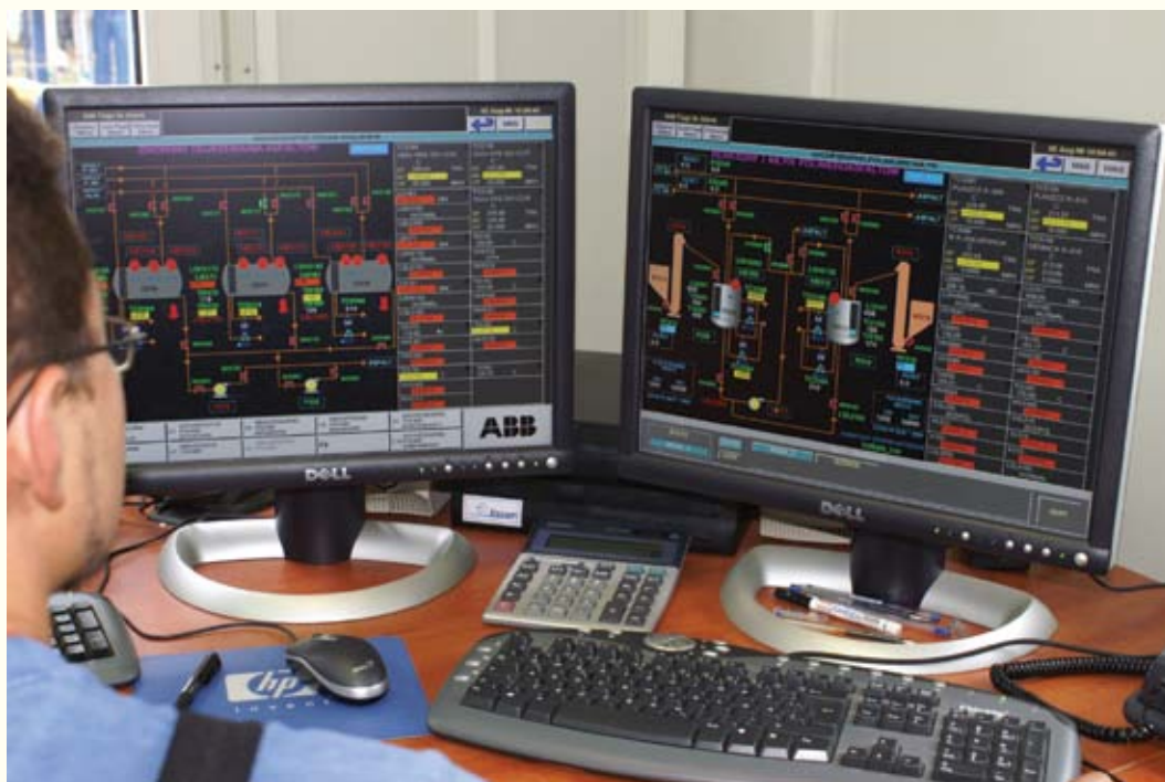
Rys. 2.4. System komputerowy DCS do sterowania produkcją asfaltów modyfikowanych ORBITON na instalacji w Płocku
