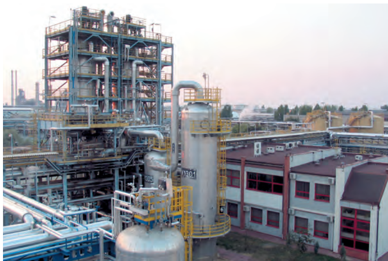
Рис. 1.3. Установка непрерывного окисления – реакторы BITUROX® (фото „ORLEN Asphalt“)
