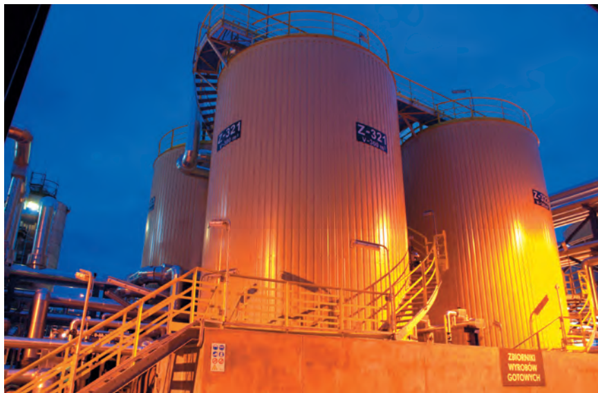
Figura 12.3. Rezervoarele pentru bitum modificat, instalația din Płock (fot. ORLEN Asphalt sp. z o.o.)
