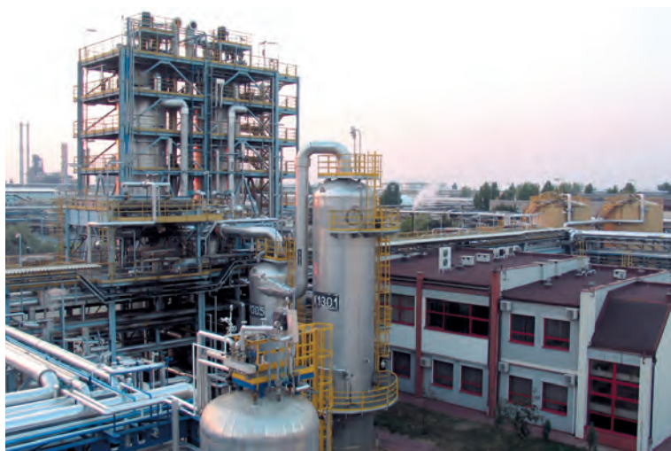
Figura 1.3. Instalația de oxidare continuă – reactoarele BITUROX® (fot. ORLEN Asphalt)
